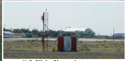
ILS Glide Slope Antenna
